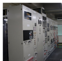
変電所 所内盤
