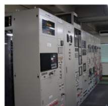
変電所 所内盤
